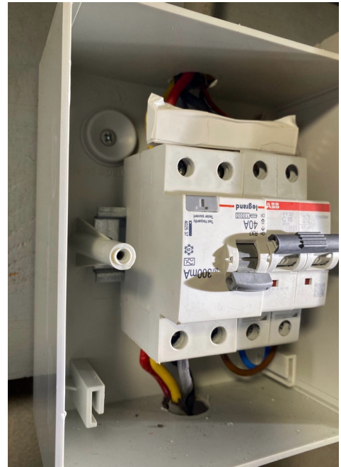
( Elektrisch bord - binnenkant )
